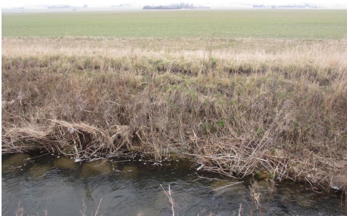
Figur 59. Råbydike vid stora Bjällerup. Branta slänter med erosion. Stora stenar/block har lagts i diket troligen för att minska erosionen vid kulvertens mynning.
