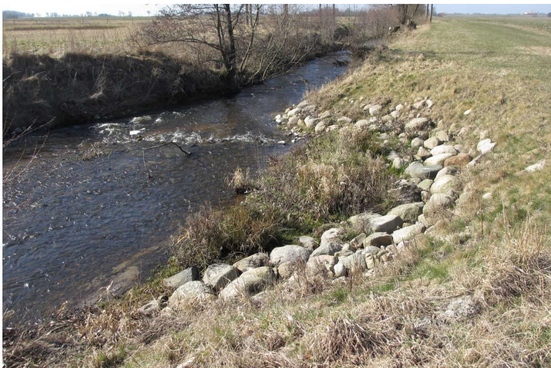
Figur 26. Höje å nedströms Gödelövsbäckens mynning. Erosionsskydd i slänten.
