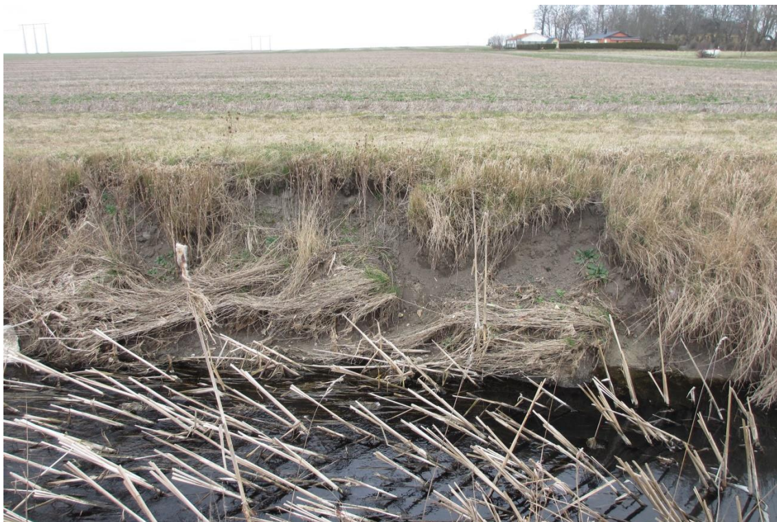
Figur 55. Råbydiket vid mynningen i Höje å. Erosion av dikets norra slänt. På fotot syns även en del vegetation i diket.
