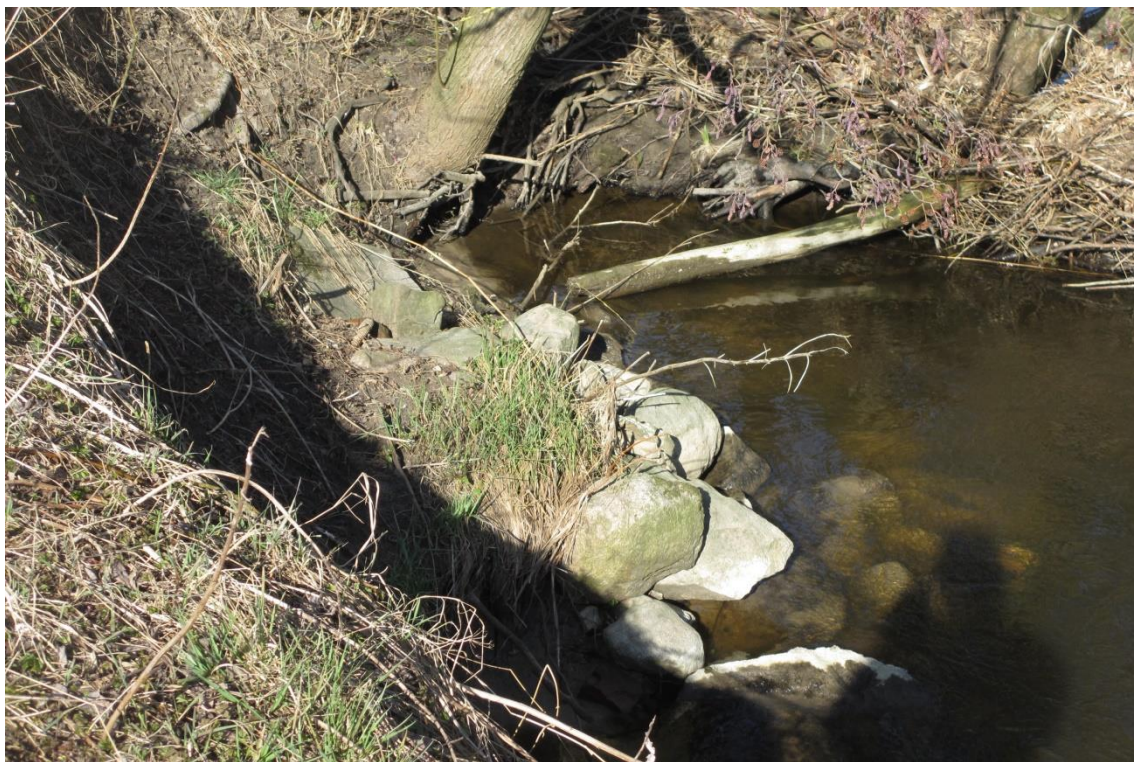
Figur 16. Höje å nedströms Alberta. Stenar har placerats i slänten för att förhindra fortsatt erosion på vissa platser.
