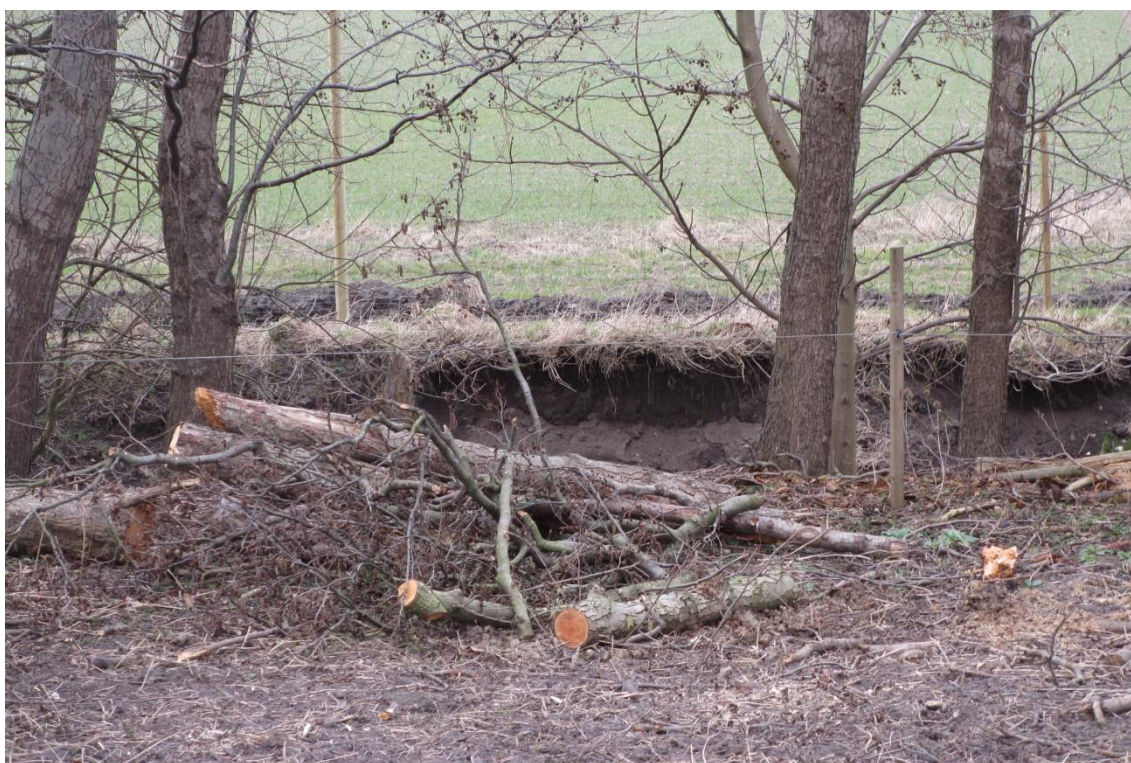
Figur 43. Vallkärrabäcken vid Lilleby. Erosion av slänten i de övre delarna av sträckan.
