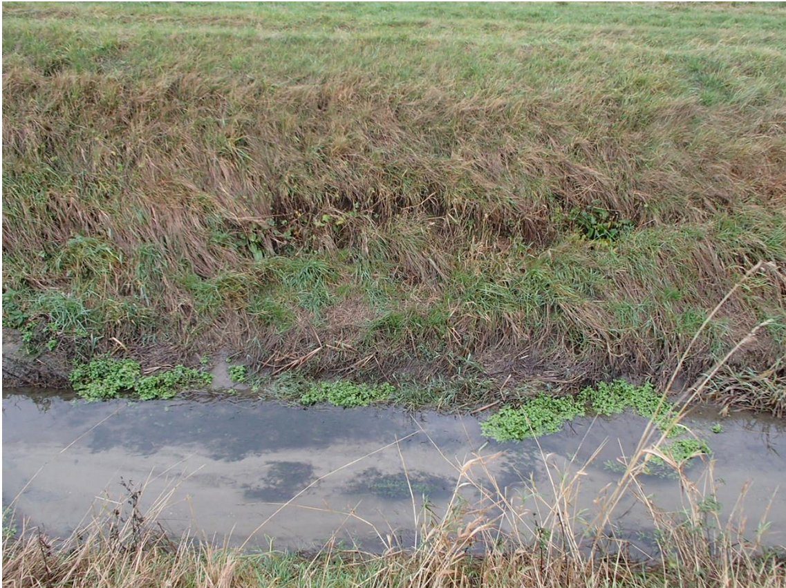
Figur 65. Dalbydiket nedströms reningsverket. Erosion av slänt i Dalbydiket i de nedre delarna av karterad sträcka.
