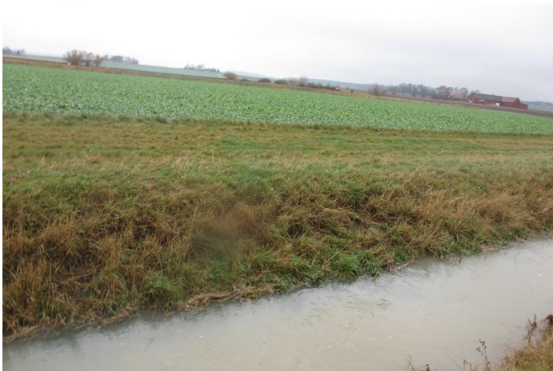
Figur 75. Dalbydiket nedströms damm på fastighet Dalby 2:5. Lite erosion i slänt.
