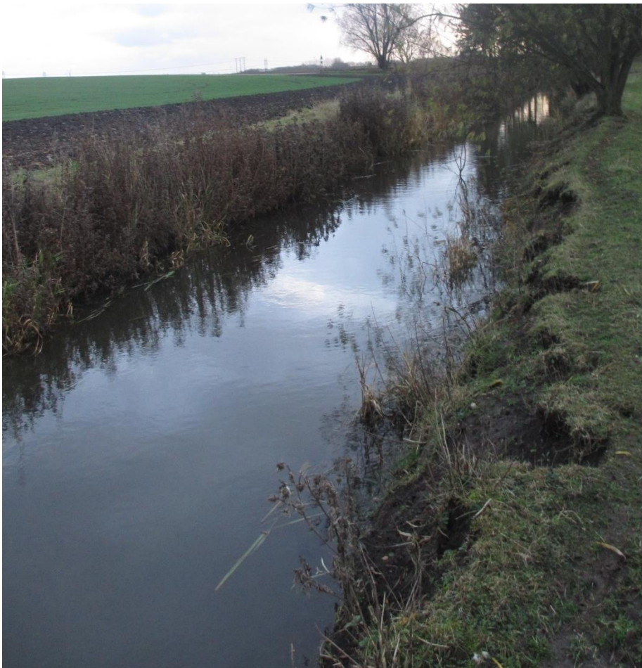
Figur 56. Dynnbäcken nedströms Vesumsvägen. Erosion längs Dynnbäcken. På denna del av sträckan finns betande får som kan medföra att erosionen är något kraftigare här genom att fåren har trampat på slänten.
