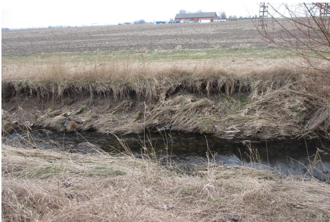
Figur 59. Erosion av slänten i Råbydike nedströms Lilla Bjällerup.
