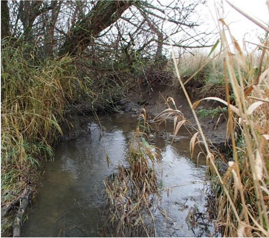
Figur 38. Vallkärrabäcken uppströms Fjellie. Erosion i nedströmsdelen av sträckan.
