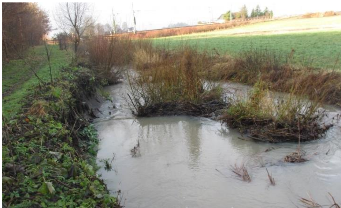
Figur 46. Vallkärrabäcken uppströms järnvägen. Piluppslag i mitten av bäcken har medfört erosion av bäckens slänter.
