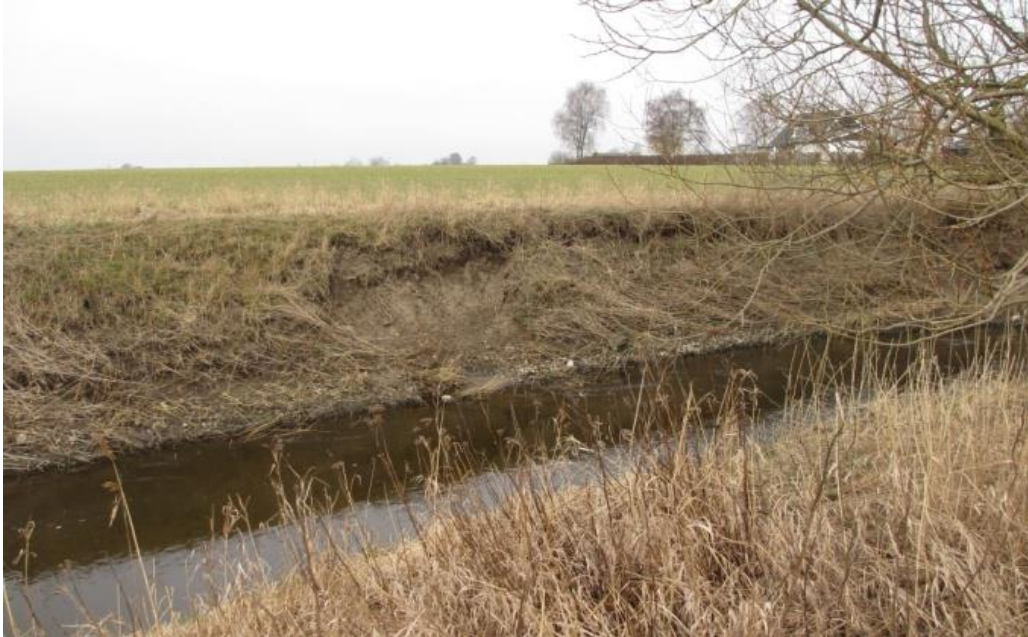
Figur 18. Höje å nedströms Kyrkheddinge. Erosion av åns västra slänt.
