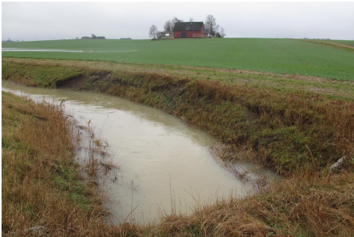
Figur 72. Dalbydike söder om damm på fastighet Dalby 21:27. Erosion av den södra slänten i Dalbydike.
