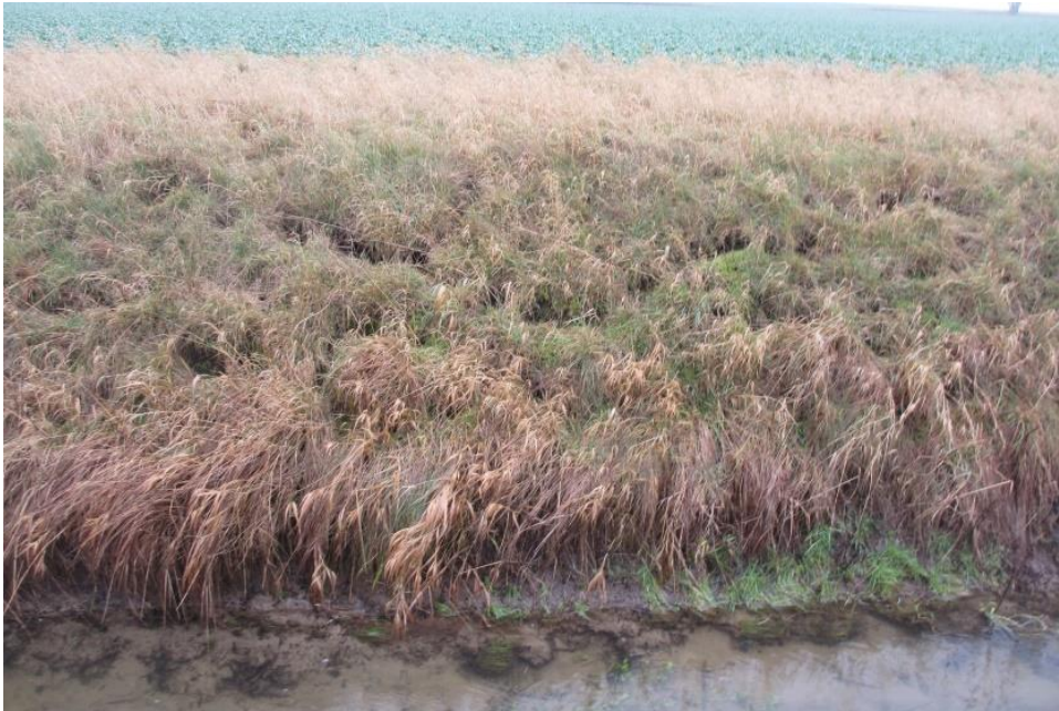
Figur 52. Dike nedströms Fels mosse. Erosion i slänten
