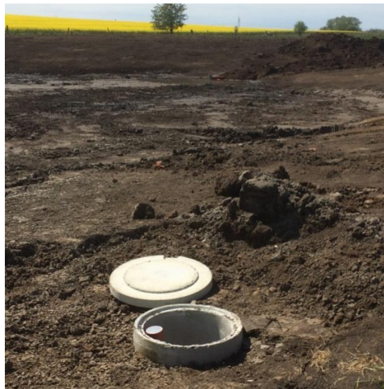
Bräddutloppsbrunnen satt i slänten av fosfordammens grunddel.
