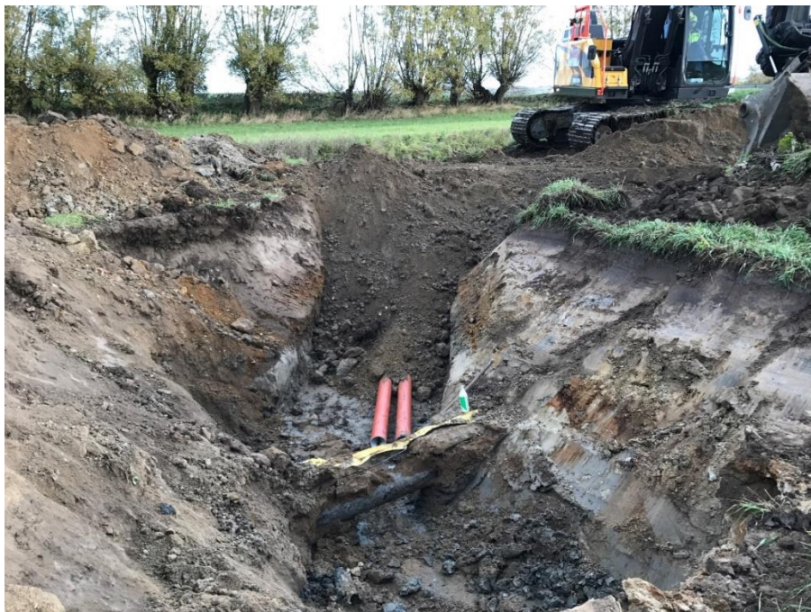
Bild 3. Inloppsrör från diket, löper under gasledningen i förgrunden.
