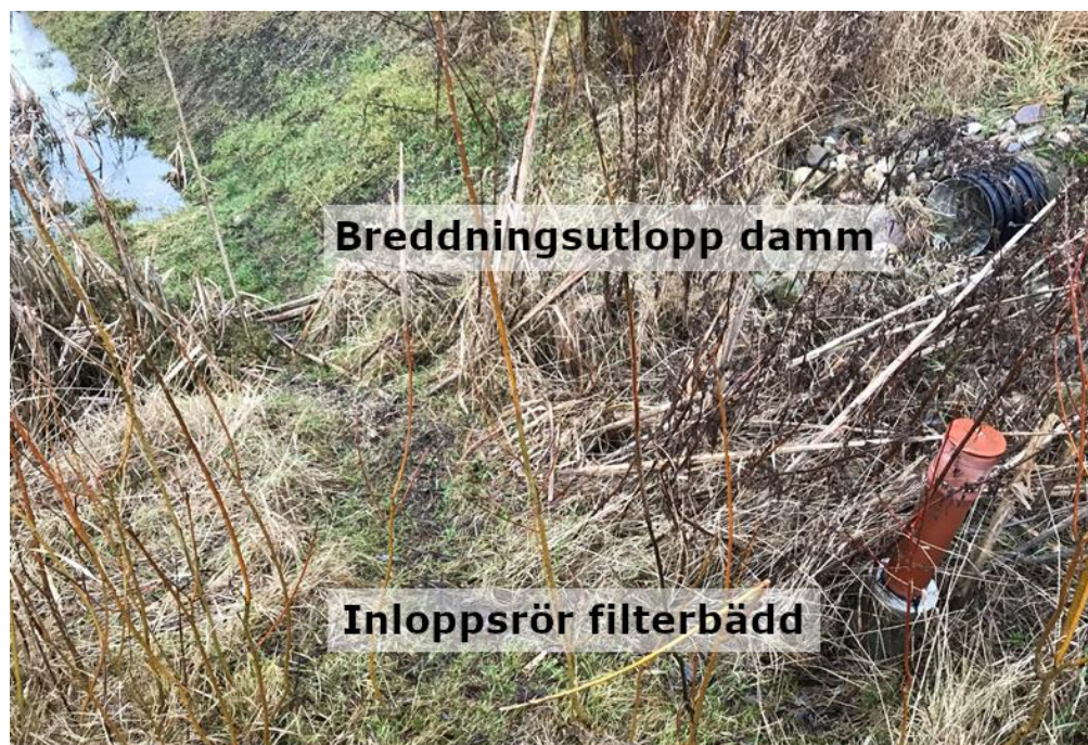
Figur 22. Inloppsrör (rött med perforerad metallcylinder) till filterbädden Trolleberg öst. Breddningsutlopp till damm (svart) syns också i bild. Inloppsledningen till dammen är inte vattenförande på grund av att planerad påkoppling av dräneringsledningar inte har gjorts. Bilden är tagen 2021-01-13 i samband med en höglödessituation.
