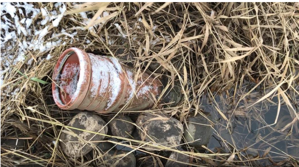
Figur 24. Ett stigarrör på utloppsledningen till filterbädden Trolleberg väst möjliggjorde provtagning.
