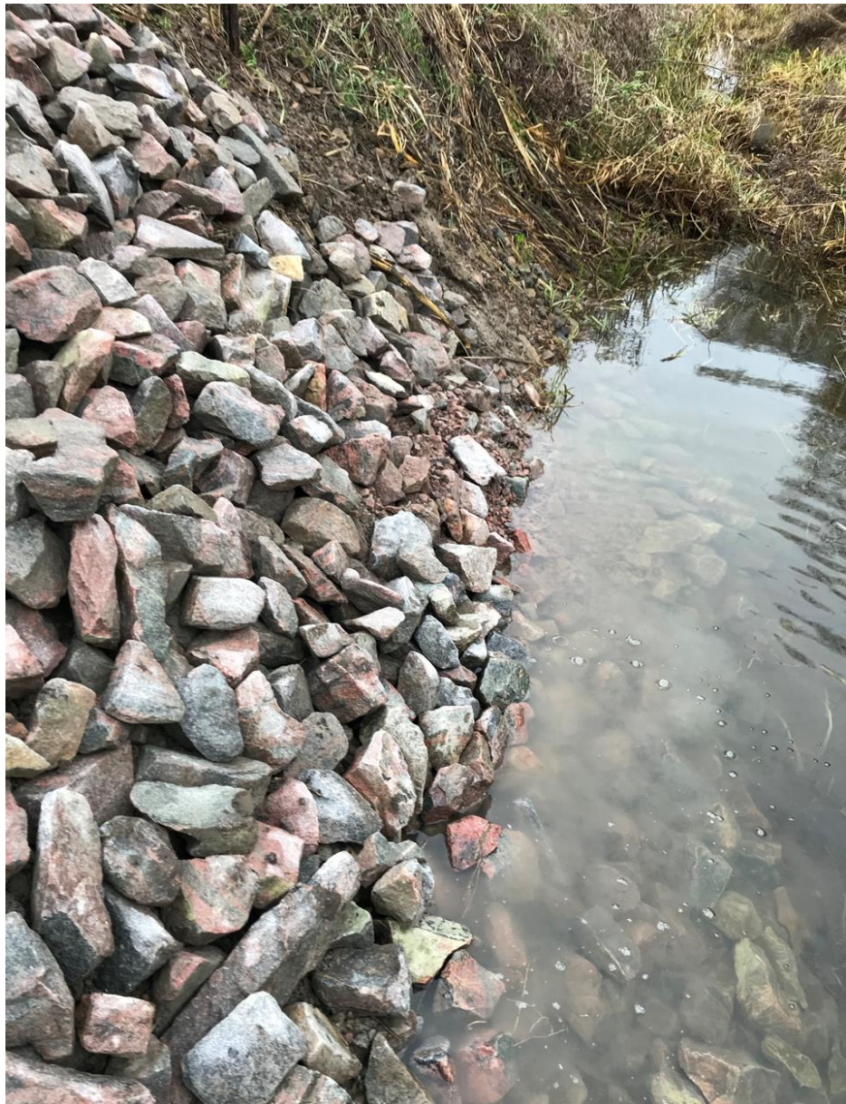
Figur 25. Utloppsroren från filterbädden vid Lilla Bjällerup mynnar i en bädd av makadam under vattenytan i Råbydiket. Vid låga vattenstånd i Råbydiket rinner i princip inget vatten genom filterbädden, vilket gör att provtagning på utloppsvattnet inte är möjlig.
