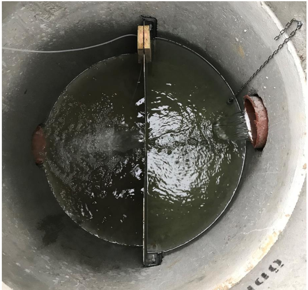
Figur 13. En av mätbrunnarna nedströms filterbäddarna. Slangen till provtagarpumpen kan ses i bildens övre del. Vattnet från filterbädden kommer ut ur röret till höger i bild, rinner över det triangulära överfallet (Thomson) i den täta mellanväggen, och sedan ut i röret till väster i bild. Till höger i bild syns en kedja med en tryckgivare (Van Essen Instruments TD-Diver). Tryckgivaren mäter vattennivån på uppströmssidan av mellanväggen, vilket möjliggör beräkning av flödet över överfallet. Vid varje provtagningstillfälle mättes vattennivån manuellt för att data från tryckgivaren skulle kunna kalibreras i efterhand.
