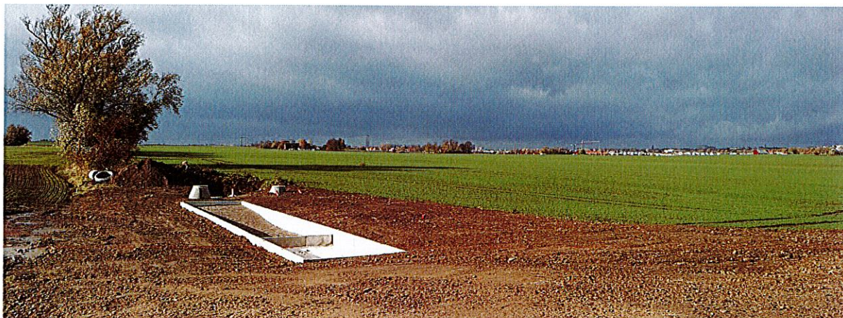
Fosforfilter vid Råbytorp. Till vänster i bilden ligger Nordkalks öppna filteranläggning och bredvid till höger ligger Werecs övertäckta filteranläggning. Filtren som ska rena vattnet från fosfor tar emot samma mängd vatten och effektiviteten ska följas upp under 2019. I bakgrunden skymtar sydöstra utkanten av Lunds stad.
