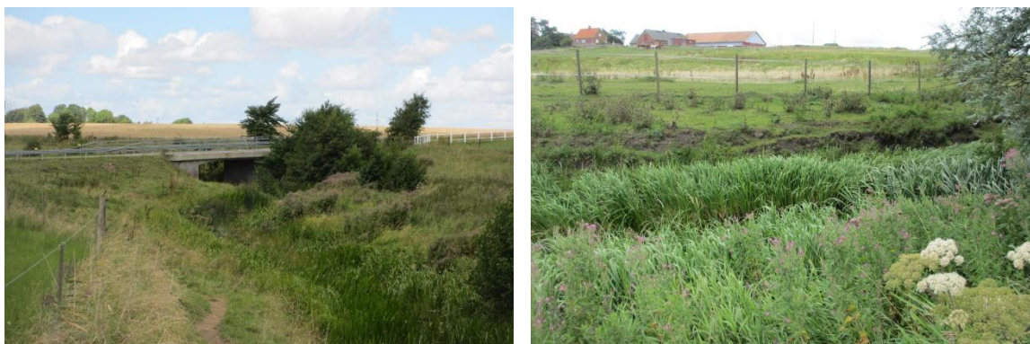
Figur 46. Vänstra bilden: bron över ån vid Albertavägen. Rikligt med vegetation förekommer i åfåran. Högra bilden: det växer vass i ån på sträckan och det förekommer en del erosion av slänten.
