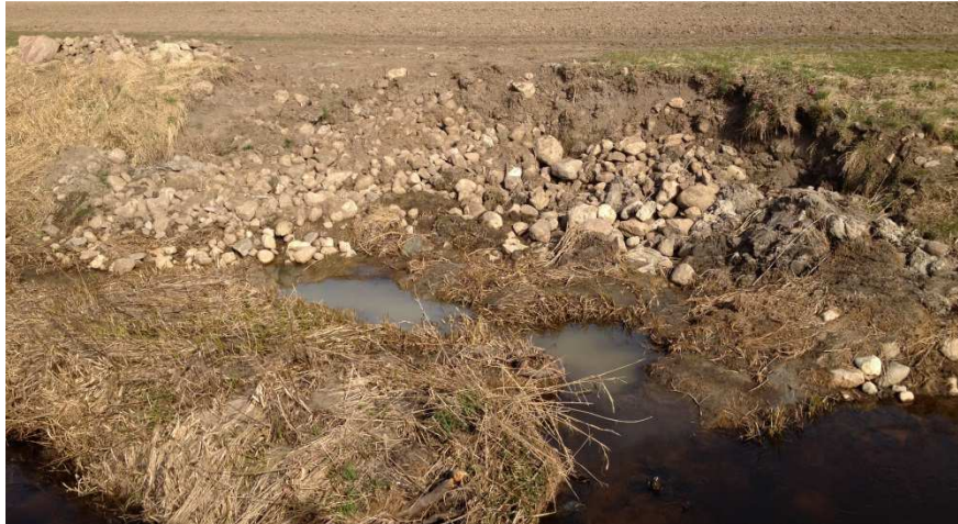
Figur 28. Erosion i Höje å
