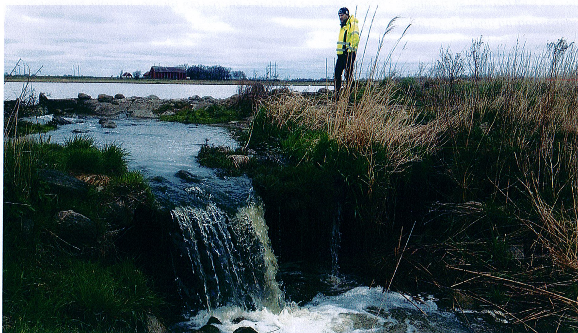
Utloppsdämnet vid damm H50 Östra Kannik är underminerat och behöver lagas och den borteroaderade häckningsön ute i dammen ska återställas. ↴
