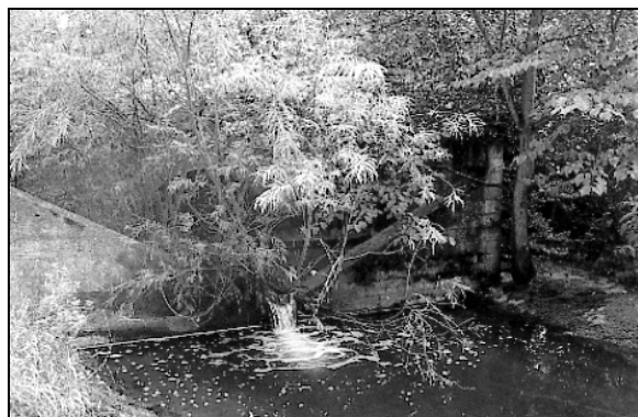
Kulvert utlopp i Höje å, hinder vid lågvatten
