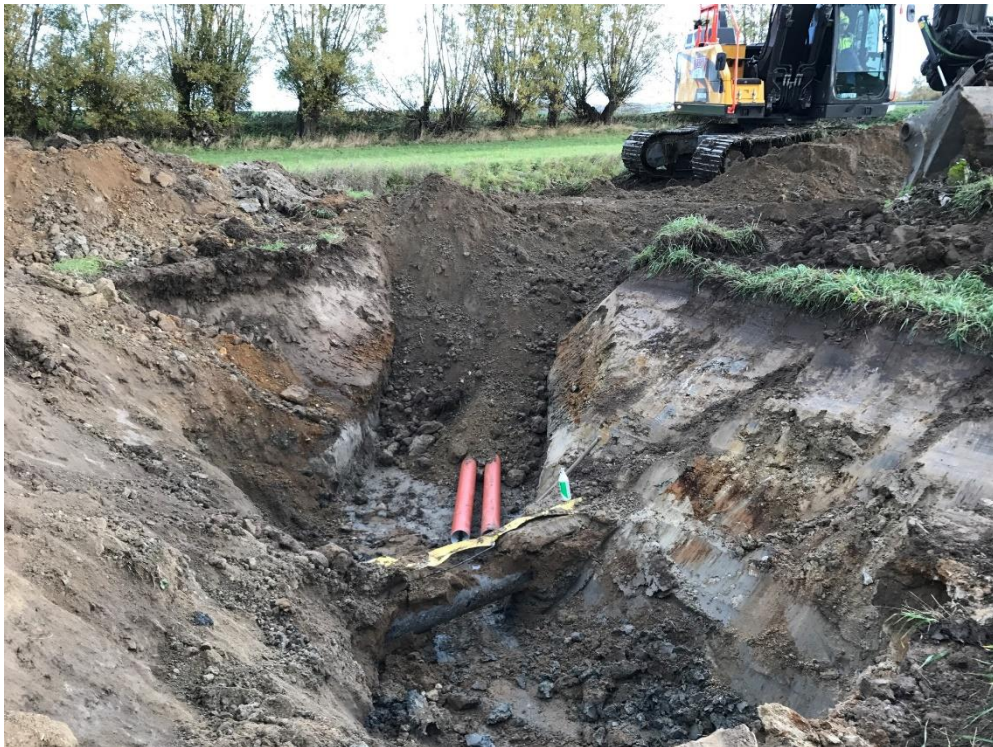
Bild 3. Inloppsror från diket, löper under gasledningen i förgrunden.
