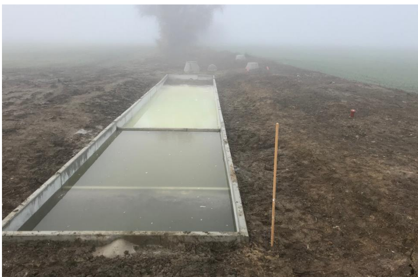
Figur 4. Området för filterbäddarna efter åtgärder. Nordkalks filterbädd till vänster och WERECs till höger (spolningsrör sticker upp). Mätbrunnar, och uppsamlingsbrunnar syns i bakgrunden.
