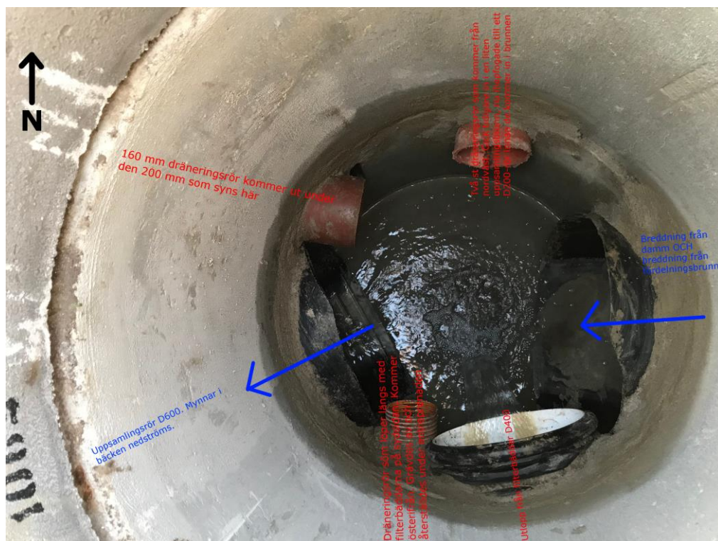
Figur 2. Uppsamlingsbrunnen i figur 12 vid besiktning (efter åtgärd).
