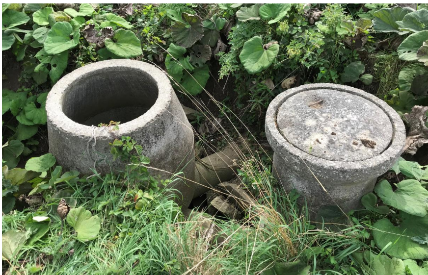
Figur 11. Uppsamlingsbrunnar nedströms anläggningen före åtgärd. Höga vattenflöden har under årens lopp eroderat bort jordmassorna runt brunnarna.
