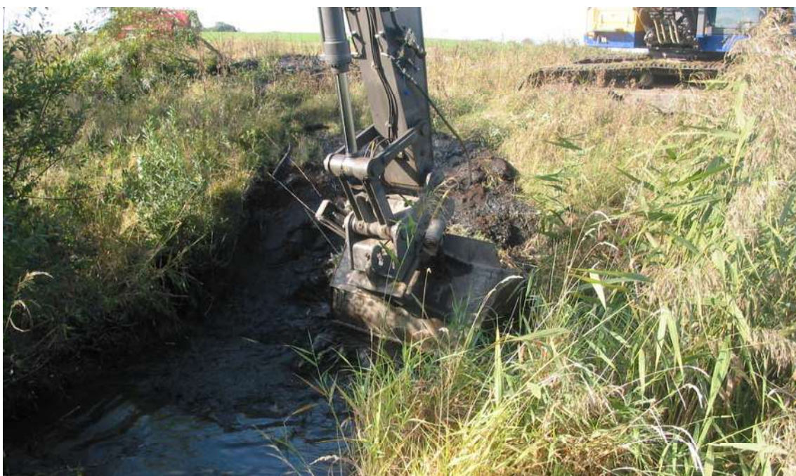
Rensning av damm i Borgeby där kraftigt igenväxning orsakat en kanalisering av vattenflödet.
