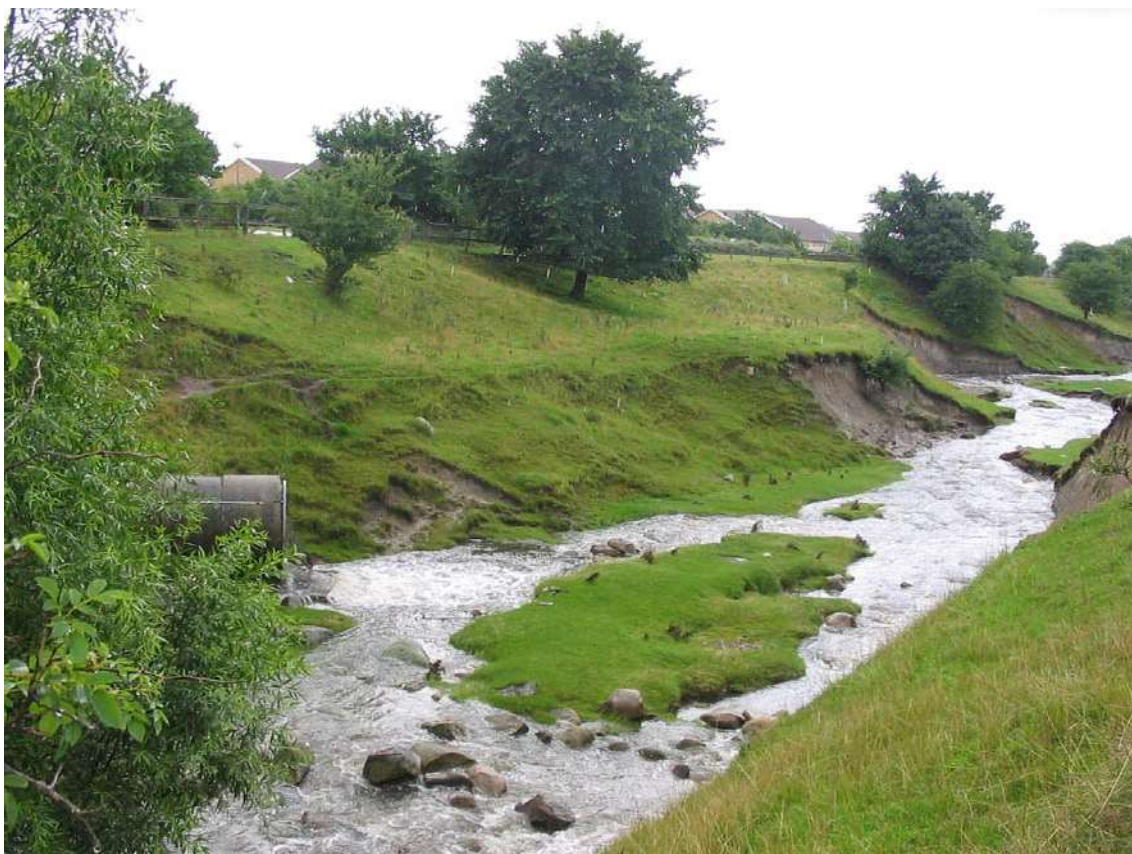
Erosion vid dagvattenutsläpp i Rinnebäcksravinen.
