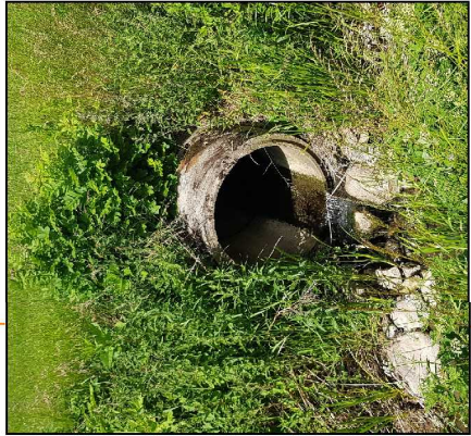
Dagvattenutlopp från Råbysjön
