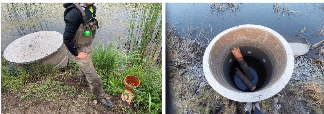
Bild 84. T.v. Nivåbrunnen har ett lätt metallock med handtag på sidan, till höger i bilden syns också ett rör med rörbøj som fungerar som säkerhetsrör vid höga flöden; T.h. Bild från tillfälle när våtmarken är under tömning, båda rören är dragna.
