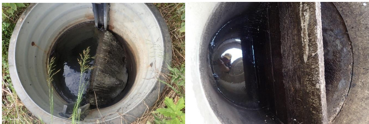
Bild 12. T.v. Valfungerande platsmunk med träplanksättning (A6); T.h. en gammal betongmunk med träplanksättning som med åren ruttnat och som för dagen inte håller vatten (A1).
