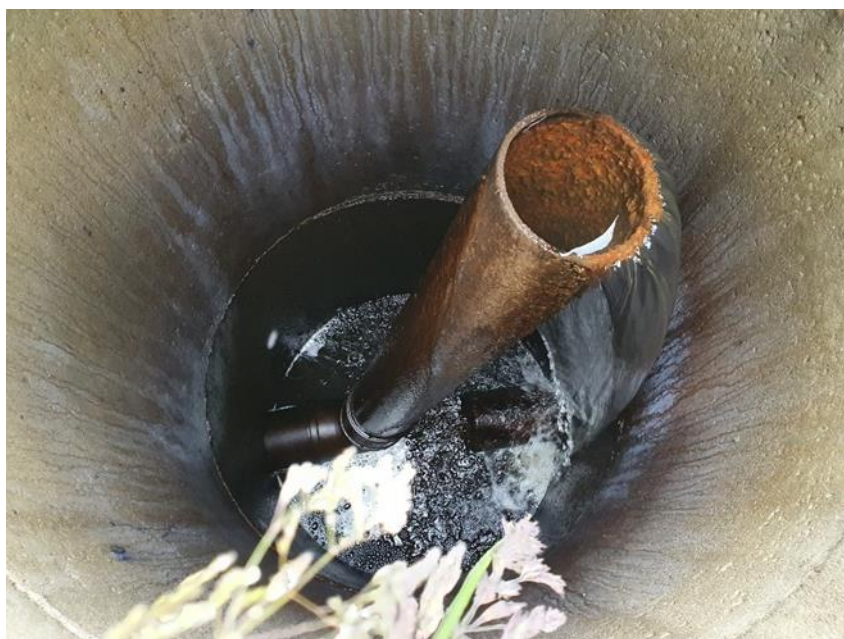
Bild 11. Nivå/reglerbrunn med inloppsvattnet genom ett långt stigar-rör. Våtmarken fungerar i dagsläget utan läckage men efter tömning skapar konstruktionen svårigheter vid isättning av röret till följd av vattentrycket.
