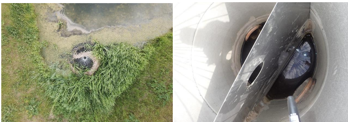
Bild 16. T.v. Exempel på hur växtlighet börjar etablera sig kring brunnen samt fastnar på brunnens sil (B4); T.h. En kombinerad störtbrunn med bottenrör och möjlighet till nivåreglerande metallskiva (B5).
