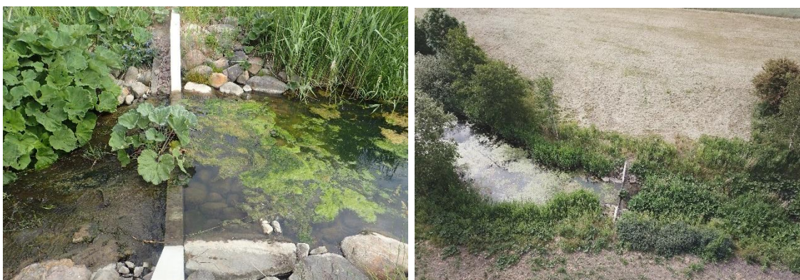
Bild 21. T.v. Ett gammalt läckande sulldämme har här ersatts med ett nytt betongdämme och natursten som erosionsskydd; T.h. Igenväxning påbörjad framförallt nedströms dämnet, men påverkar i dagsläget inte vattenföringen nämnvärt (C1).
