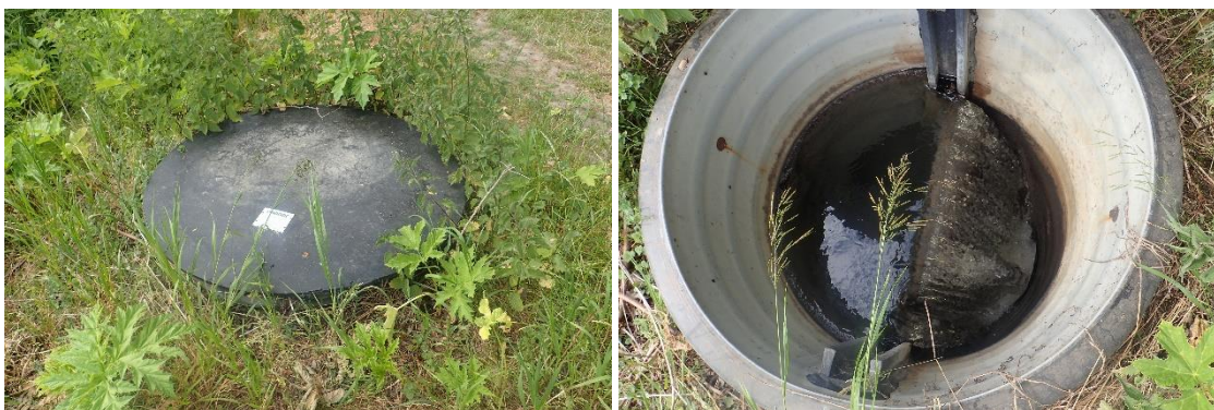
Bild 16. T.v. Utloppsbrunn av plast och träplankor, lätt brunnslöck i plast; T.h. Visst läckage i brunnen men utan påverkan då VG ligger på utsatt maxnivå.
