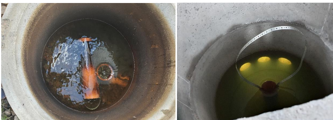
Bild 25. T.v. Exempel på hur det kan se ut när man dragit nivåröret (som nu ligger i brunnen) för att tömma våtmarken (E5); t.h. med isatt nivårör med ett ordentligt handtag för att lyfta vid behov.
