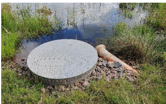
Bild 82. Brunnen har ett lätt metall-lock med handtag för förenklad skötsel. Vattnet leds in i brunnen mha infiltration genom makadam och hål i betongringen. Till höger i bild ses ett mindre säkerhetsrör.
