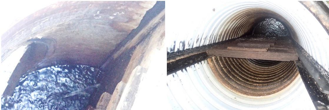
Bild 13. T.v. Här syns ett mindre läckage mellan planksättorna (A5). Inget vatten rinner över den satta vattengången; t.h. Extra lister på plankorna underlättar skötseln eller byte av plankor då dessa kan lyftas med en kratta (A4).
