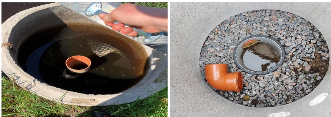
Bild 87. T.v. Nivåbrunn med ett par centimeter kvar till satt max-nivå, lätt metall-lock; T.h. Brunnan vid anläggning, Vattnet leds in i brunnen mha infiltration genom makadam och hål i betongringen.
