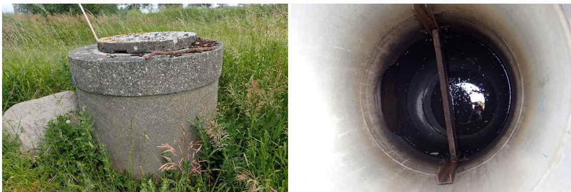
Bild 5. T.v. Utloppsbrunnen (munk) med betonglock; T.h. Djup brunn med träplankor, samma vattennivå på båda sidor om planksättningen talar för läckage, står dock vatten in från recipienten (dike) in i brunnen.
