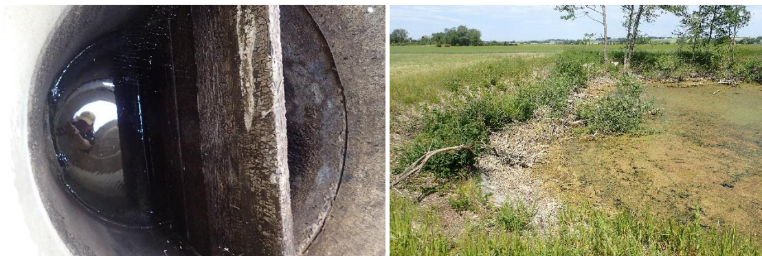
Bild 3. T.v. Bild från munken som uppvisar tydliga tecken på läckage och ruttnade träplankor, rinner ur utloppet trots ca 60-70cm till satt VG; T.h. Våtmarken håller idag inte vatten.
