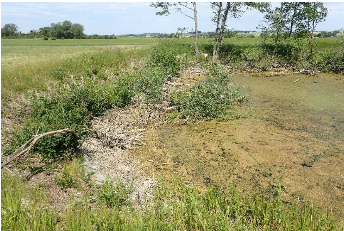
Bild 14. (A1), flöde i utloppet till följd av läckage i brunnen är troligtvis anledningen till att våtmarken vid besöket inte höll utsatt vattennivå, dock besöktes våtmarken vid torka och inkommande flöde har inte noterats.
