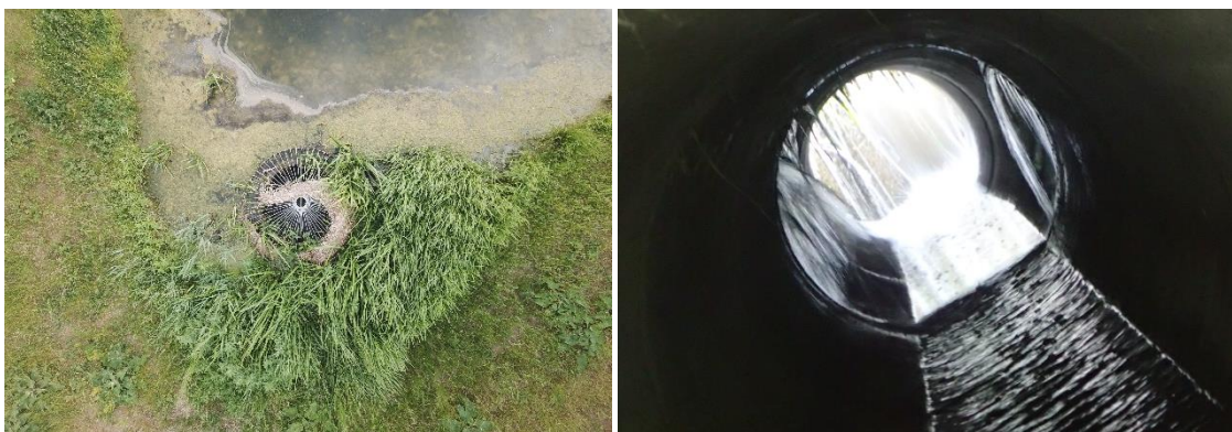
Bild 27. T.v. Igenväxning kring brunnen börjar påverka risken för dämning av vegetation; T.h. Fotografering genom utloppsröret mot brunnen visar läckage mellan betongringarna i sektioner under vallen. Svårt att lokalisera i våtmarken men blir tydligt i röret.
