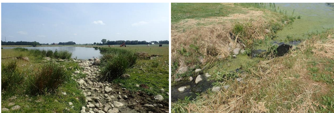
Bild 20. T.v. En väl nedgrävd järnspons i kombination med stensättning, för dagen torrt men uppvisar inga tecken på större erosion och klarar betesdjurens tramp väl (C5); T.h. Ett mindre gummidämme ca 20 år gammalt. Vegetation kring utloppet sköts noga och uppvisar därför inga tecken på igenväxning (C5).
