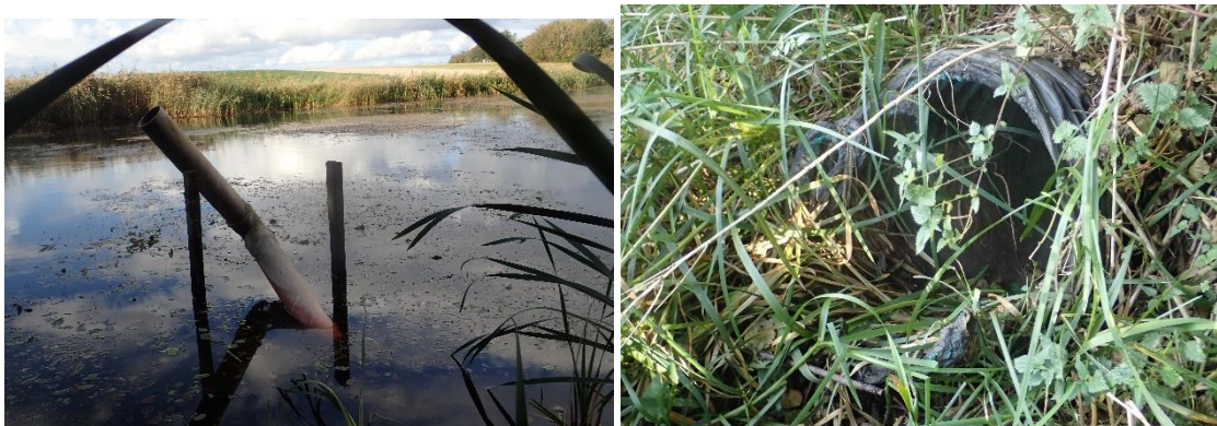
Bild 90. T.v. Ett eksempel på når snabeln har lossat från botten/vallen og nivåerna blivit helt felaktige som följd; T.h. Sikkerhetsrør som idag fungerer som våtmarkens utløpp till följd av att snabelrøret er ur funktion.
