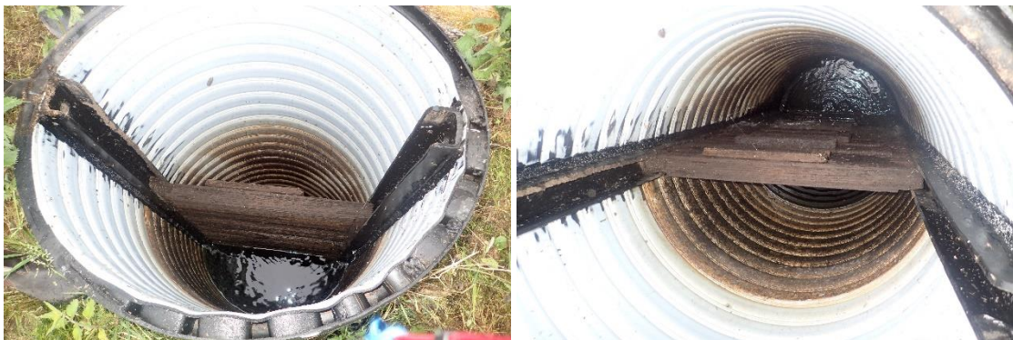
Bild 11. T.v. Utløppsbrunn av plast og med träplankor; T.h. Visst mindre läckage mellan plankorna men våtmarken håller vatten. Trållister sitter på plankorna för att underlätta byte av plankor med hjälp av till exempel en kratta.
