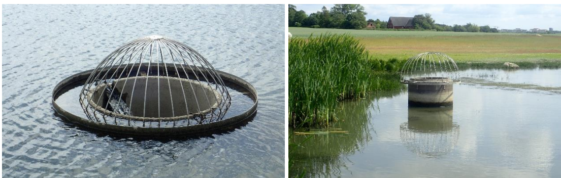
Bild 15. T.v. Störtbrunn med skyddande metallring för flytande växtlighet (B1); t.h. Störtbrunnar är placerade ute i våtmarken och blir på så vis svåra att nå för skötsel eller inspektion (B2).
