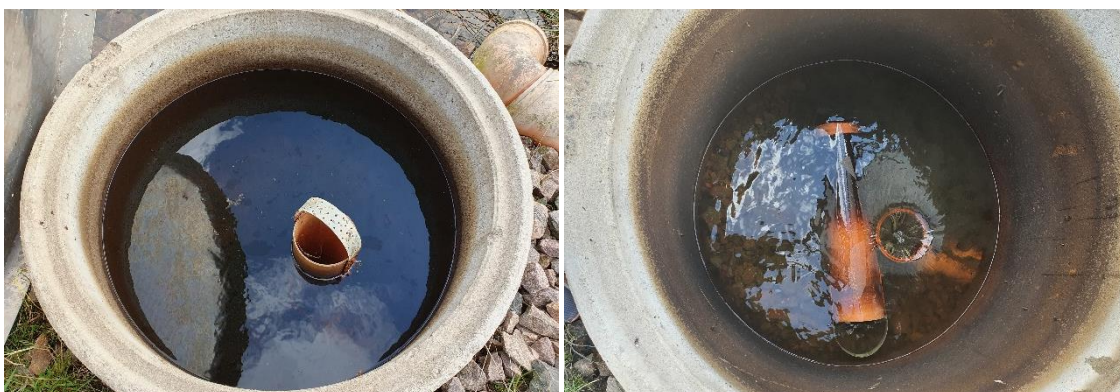
Bild 81. T.v. Nivåbrunnen, där nivån vid besöket inte går över utsatt VG på nivåröret; T.h. Draget nivårör vid ett tömningstillfälle, liggande löst i brunnen är nivåröret med handtag som förenklar när det skall lossas.
