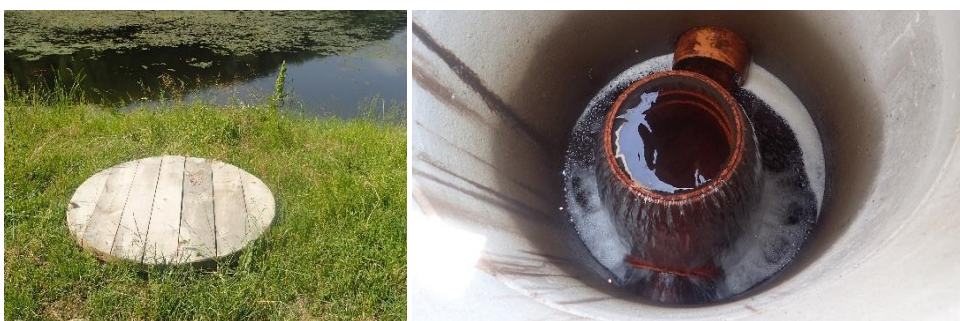
Bild 70. T.v. Lätt trälock på nivåbrunnen; T.h. Nivåbrunnen är idag huvudsakliga utløpp.
