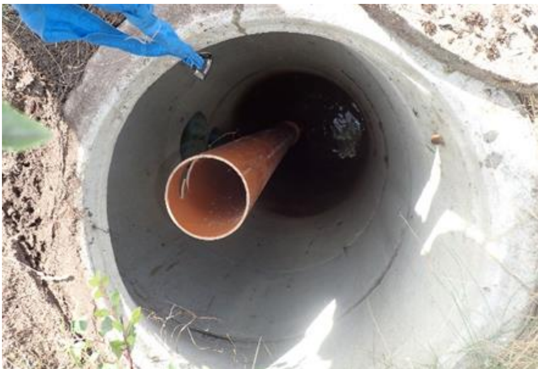
Bild 26. E1, vatten leds in i brunnen via bottenrör. Mycket djup brunn som försvårar skötsel.
