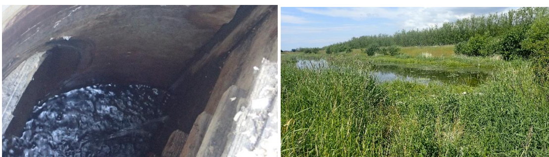
Bild 14. T.v. Mindre läckage mellan plankläggningen; T.h. Körbara bräddningen med våtmarken i förgrunden, inga tecken på erosion eller negativ påverkan/funktion på bräddningen eller dess körbarhet.
