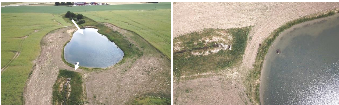
Bild 18. T.v. Översiktsbild med pil för ritningen av rör från störtbrunnen under den körbara vallen; T.h. Störtbrunn och våtmark till vänster och öppet dike till nedliggande recipient till höger, stort fall mellan våtmark och öppet dike, anlagd genom främst dämning.
