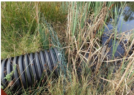
Bild 94. Säkerhetsrör som skyddas med nät.
