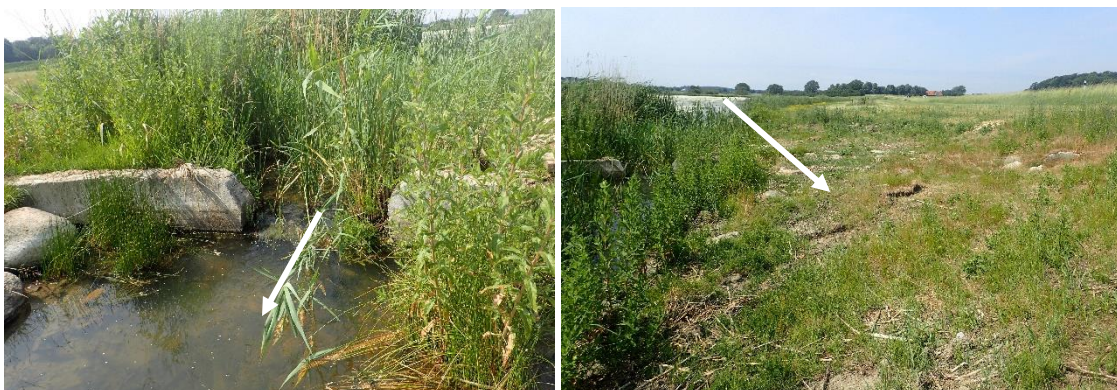
Bild 51. T.v. Betongdämnet; T.h. Troligt har vattnet passerat vid sidan av dämnet vid högflo.
