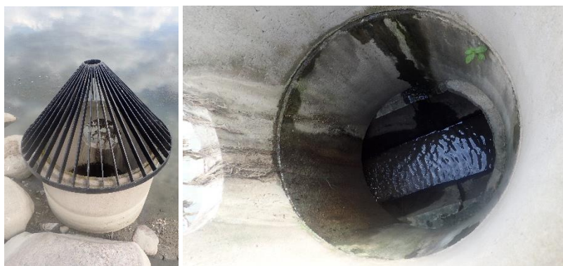
Bild 24. T.v. Störtbrunn med en större öppning i betongringen samt en "gallerhatt" som ser ut som en efterkonstruktion som inte sitter helt anpassat till brunnen; T.h. I brunnen verkar gammal kulvert under våtmarken fortfarande vara delvis intakt och delvis vattenförande.
