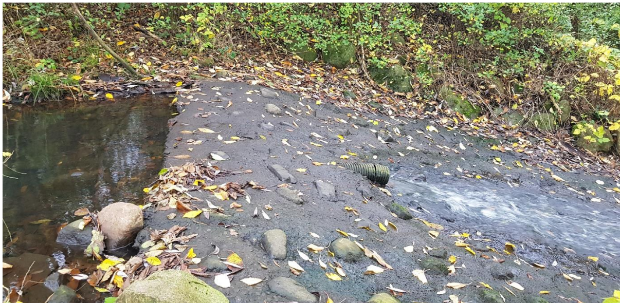
Figur 14 Utlopps dämmet vid damm H25. För att skapa en bättre fördröjning läggs ytterligare tre rör (av samma dimension som det befintliga) genom betongdämmet. 2022-11-11
