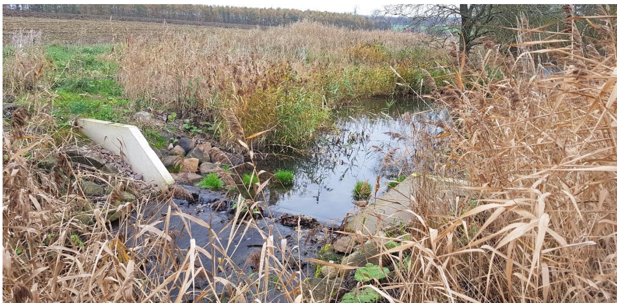
Figur 12 Utloppet från damm H18 består av ett platsgjutet betongdämme. För att skapa reglervolym sätts en 60 cm hög plåt tvärs över dämmet på uppströmssidan. I plåten stansas ett hål 30*15 cm, för att släppa igenom vatten upp till medelvattenföring på nuvarande utloppsnivå. 2022-11-11
