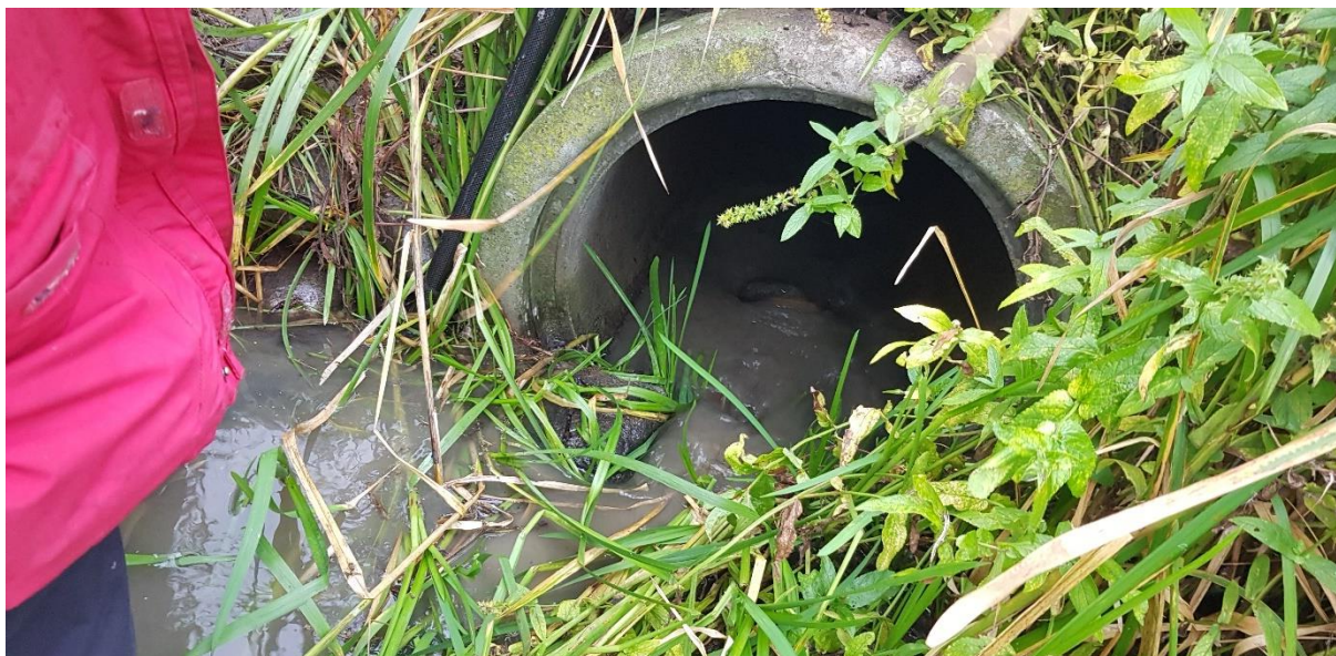
Figur 11 Utloppet från damm H14 saknar reglering. Planerad åtgärd innebär att en skålformad plåt monteras framför utloppsröret för att skapa en reglervolym. Genom plåten dras ett 90 mm rör för att leda igenom lågflöden. 2022-11-11
