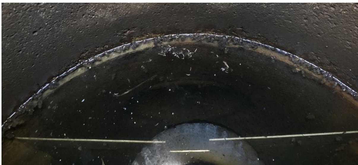
Figur 2 Utloppsbrunn damm H13 efter åtgärd. Plåt med 10 cm bred och 10 cm hög spalt syns på bilden. Vid fototillfället (2024-05-14) ligger hela plåten under vattenytan i brunnen.
