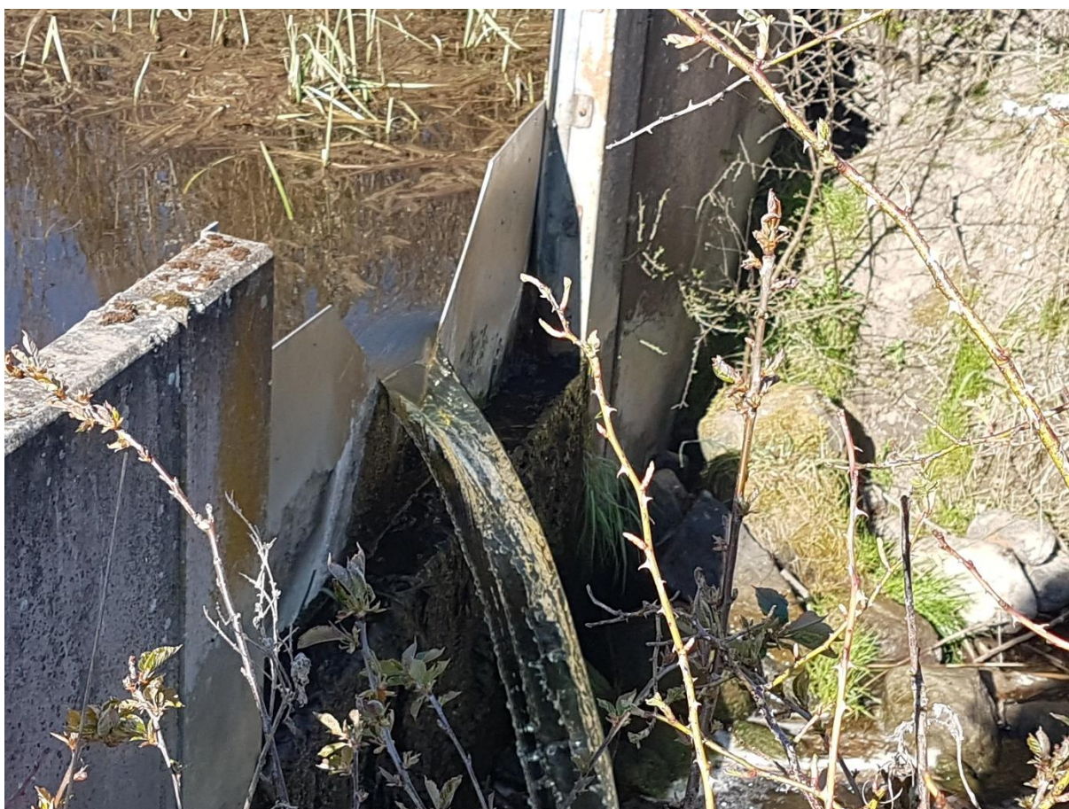
Figur 6 Utloppet från damm H38, ett Thomson-överfall. Före åtgärd 2020-04-24
